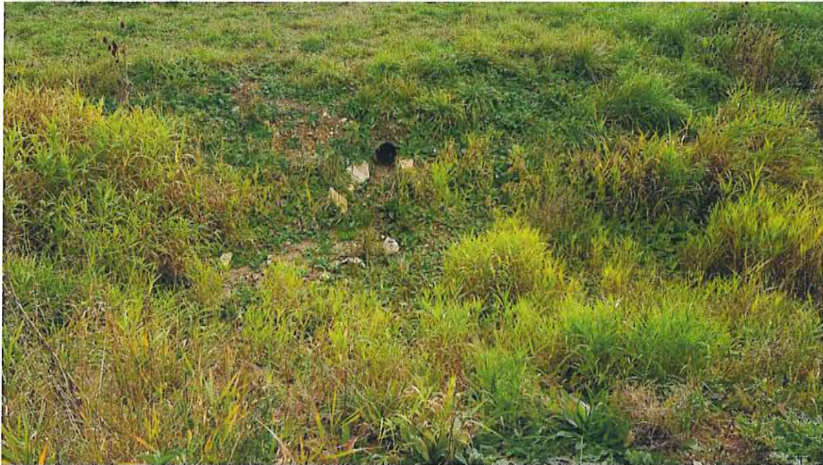
Abbildung 1: Einleitungsstelle des best. Regenwasserkanals DN 250 in die Egau
